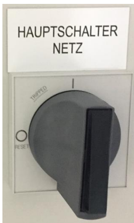
Abb. 8: Hauptschalter an der Power Unit
