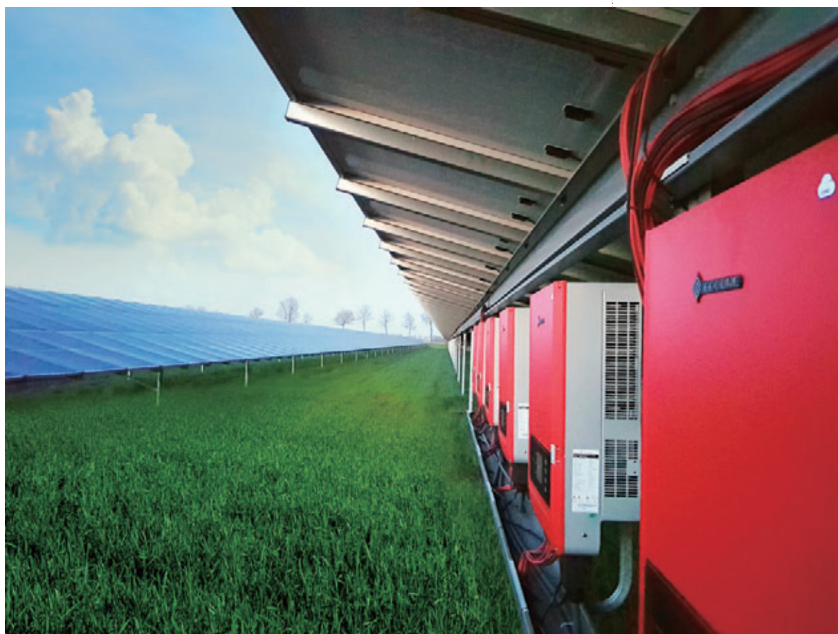
12MW Rotterdam | Niederlande
