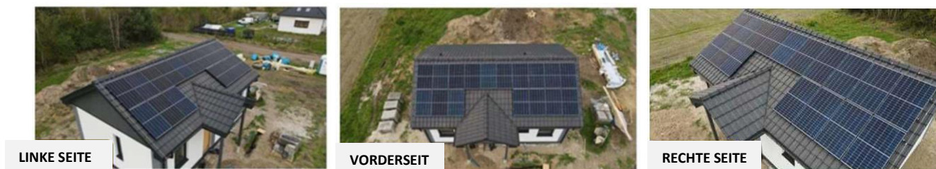
Abb.5 Beispiel einer Fotodokumentation einer Photovoltaikanlage – ANGEFORDERT VOM HERSTELLER
